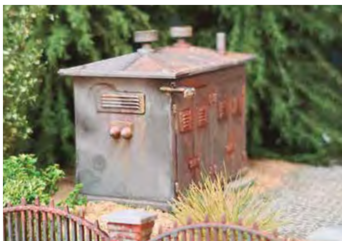
Caseta de electricidad
